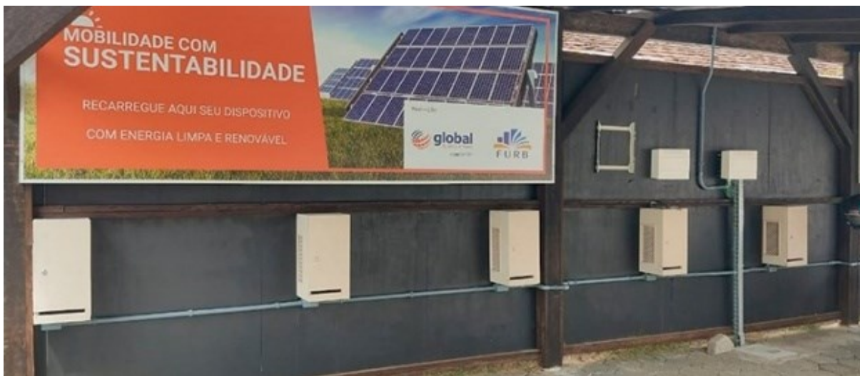
Figura 39 - Espaço de Carregamento de Bicicletas e Patinetes Elétricos'
